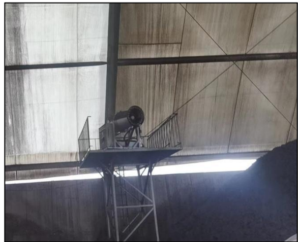
1#储煤库雾炮机
