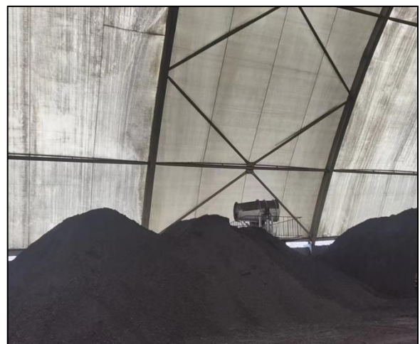
3#储煤库雾炮机
