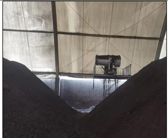
5#储煤库雾炮机
