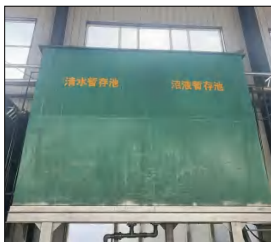
清水池、沼液暂存池
