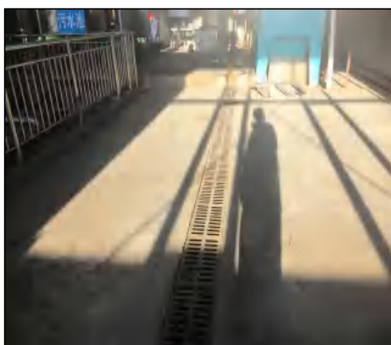
地面冲洗水导流渠
