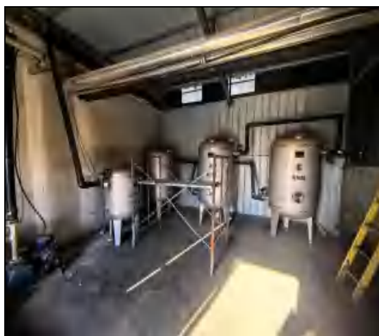
水封罐+脱水罐+干法脱硫罐
